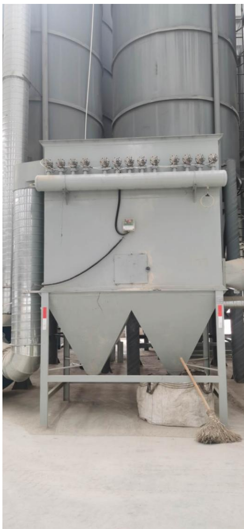
烘干废气处理设施
