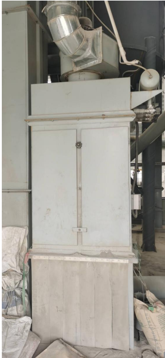
添加剂上料废气处理设施
