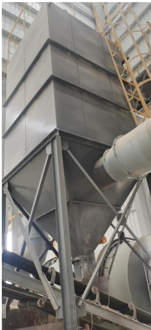
筛分、料仓、搅拌废气处理设施
