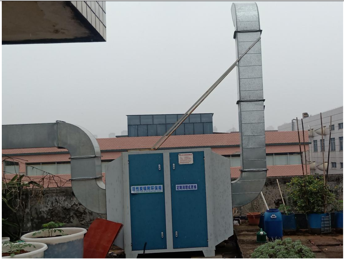
注塑废气处理设施（活性炭吸附装置）
